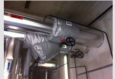
| Isolation réseau vapeur 180° C
